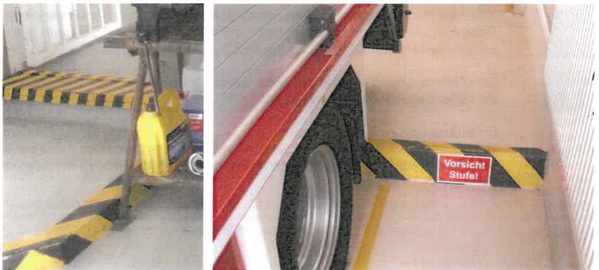
Stufen im Alarmweg – hier jedoch sehr gut gekennzeichnet
