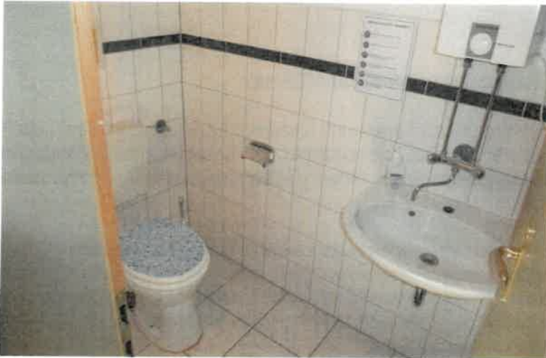
Einziges WC mit Waschbecken
