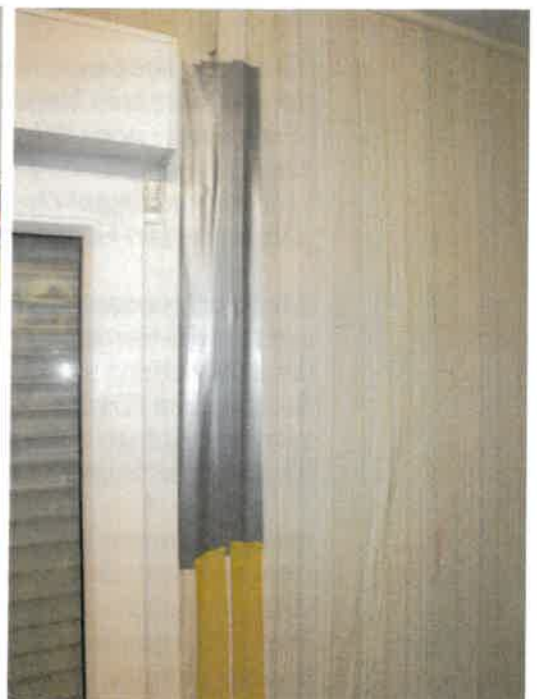
Wand des Containers durch Feuchtigkeit aufgequollen Schimmelpilzgefahr
