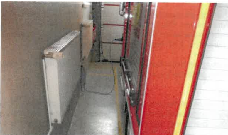
Ladekabel im Verkehrsweg
