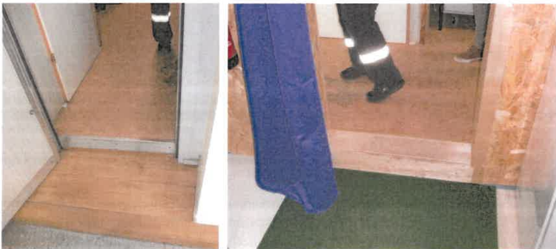
Unebenheiten im Alarmweg
