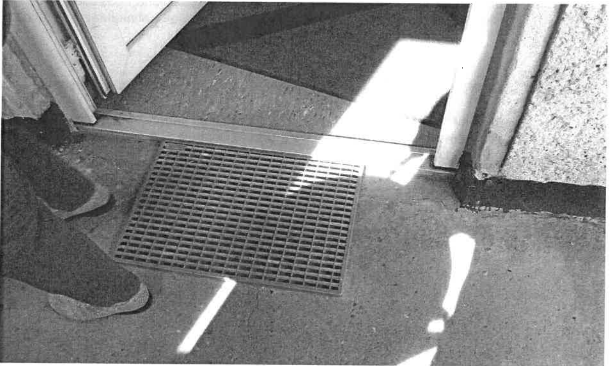
Loses nicht ebener Fußabstreifrost im Alarmweg
