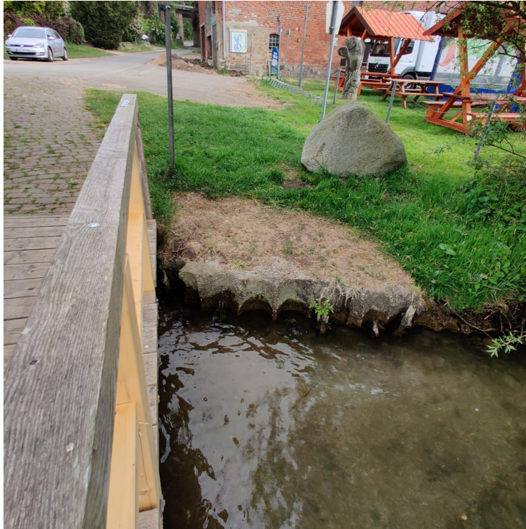
Blick auf den Uferbereich des Bootssteges. Die Betonreste müssen entfernt werden.
