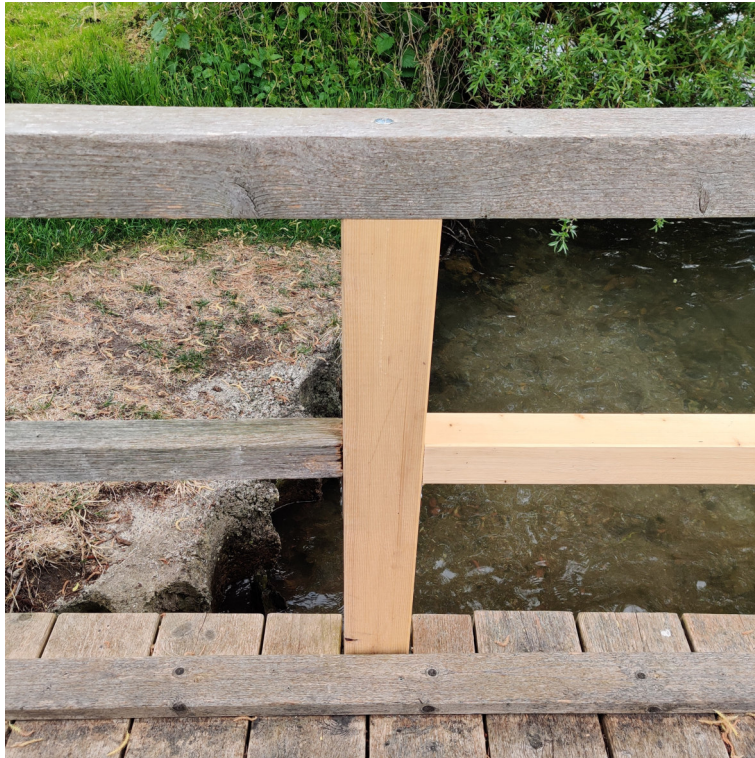
Blick auf die Absturzsicherung mit tlw. Ertüchtigten Bauteilen. Kein Holzschutz vorhanden
