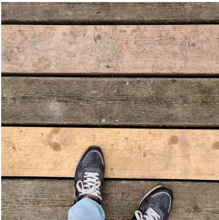
Blick auf den Belag, Austausch mit KVH ohne Holzschutz, Belag ohne Holzschutz
