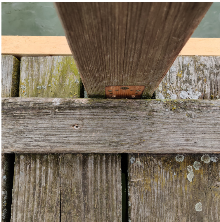
Fehlende Winkel an den Pfosten der Absturzsicherung
