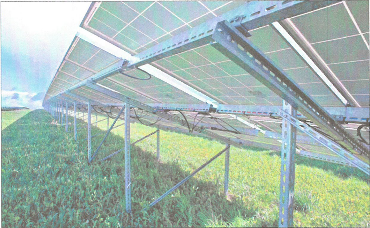
Abbildung 5: Foto Montagesystem (Quelle PUK-Solar)
