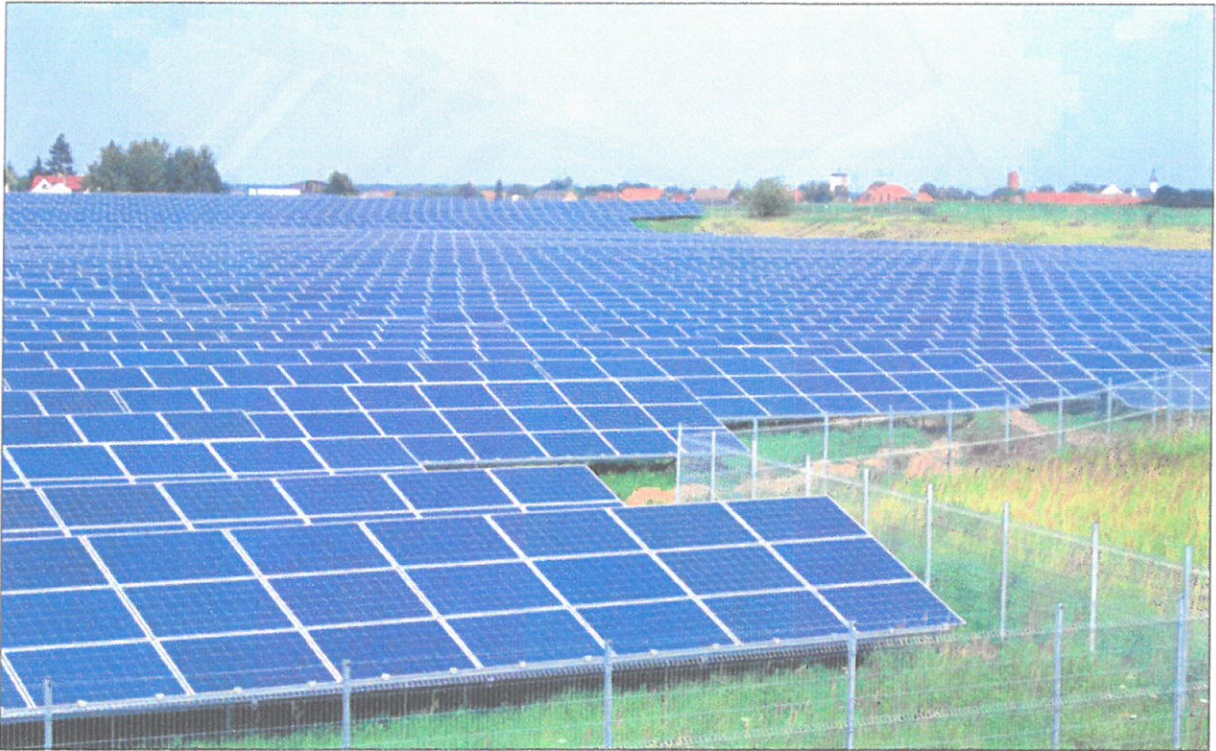
Abbildung 4: Beispiel einer Freiflächen PV-Anlage (Quelle PUK-Solar)
