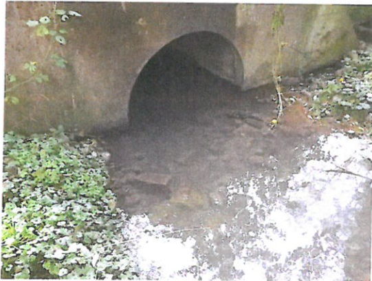
BW-19_0_2016E_SOHLE AUSLAUFSEITE STEINSCHÜTTUNG UNGLEICHMÄSSIG
