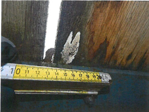
DMBK_18_0_2019H_BELAG UNTEN MITTIG PILZBEFALL
