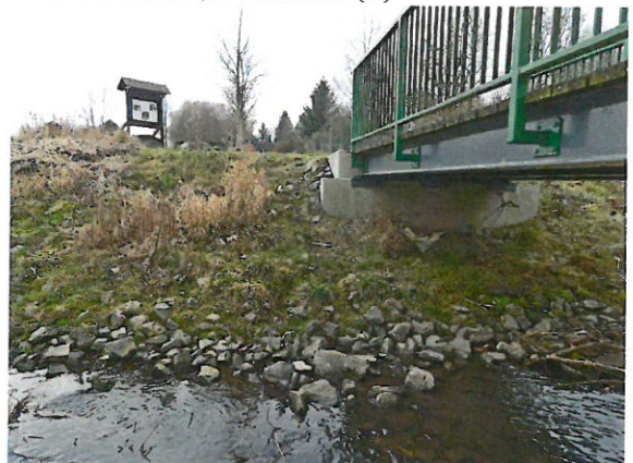
DMBK_18_0_2019H_L-BÖSCHUNG WL-H AUSSPÜLUNGEN
