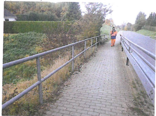
BW-19_0_2016E_HOLMGELÄNDER KEINE AUSREICHENDE HÖHE
