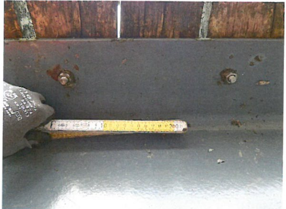
DMBK_18_0_2019H_LT-1 VORNE BESCHICHTUNG ABGEPLATZT ROST
