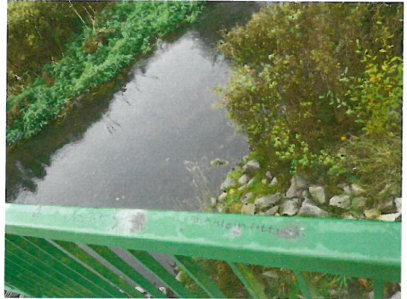
DMBK_18_0_2016E_GELÄNDERHANDLAUF RE SCHMIEREREIEN
