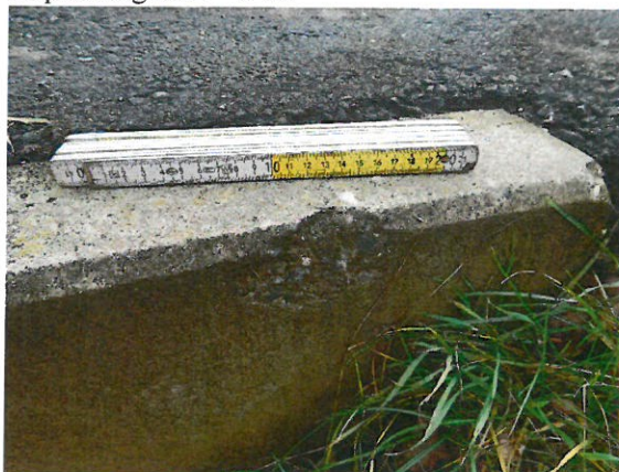
DMBK_18_0_2019H_R-FL WL-H KANTENABPLATZUNG
