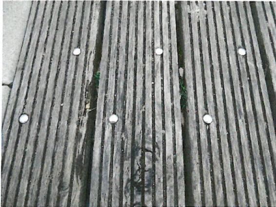
DMBK_18_0_2019H_BOHLENBELAG MITTIG FUGEN VERSANDET
