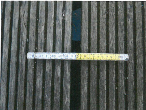
DMBK_18_0_2019H_BOHLENBELAG HINTEN FUGEN ZU BREIT
