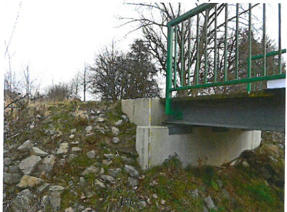
DMBK_18_0_2019H_R-FL WL-V ABSTURZSICHERUNG FEHLT
