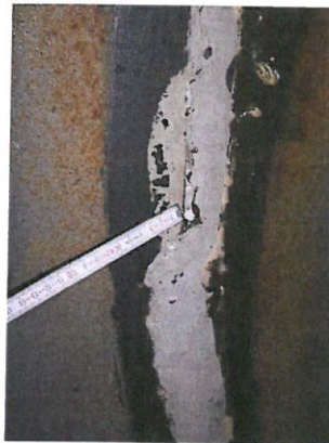
DMBK_19_0_2019H_ STOß SCHEITELBEREICH MÖRTEL FEHLT
