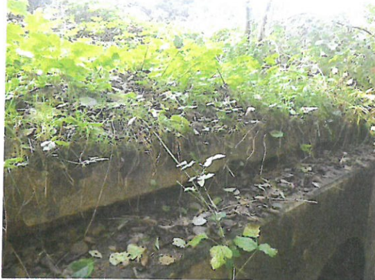
BW-19_0_2016E_RE GESIMS AUSGEBROCHEN
