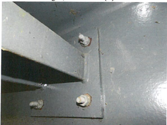
DMBK_18_0_2019H_QT-4 LINKS BESCHICHTUNG ABGEBLÄTTERT ROST
